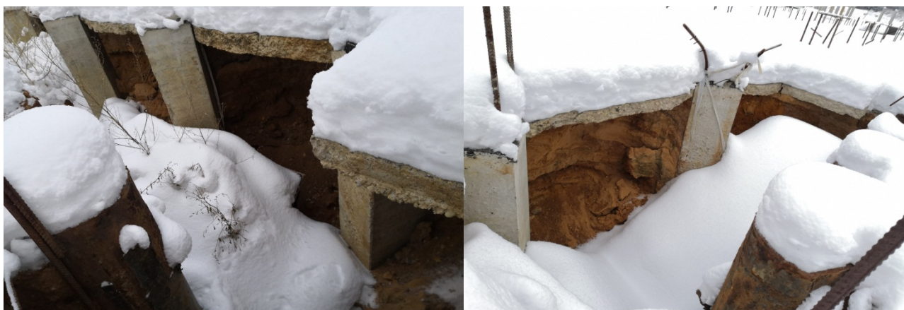
П. 5.4. Фрагменты конструкций, где произошел вымыв грунта
