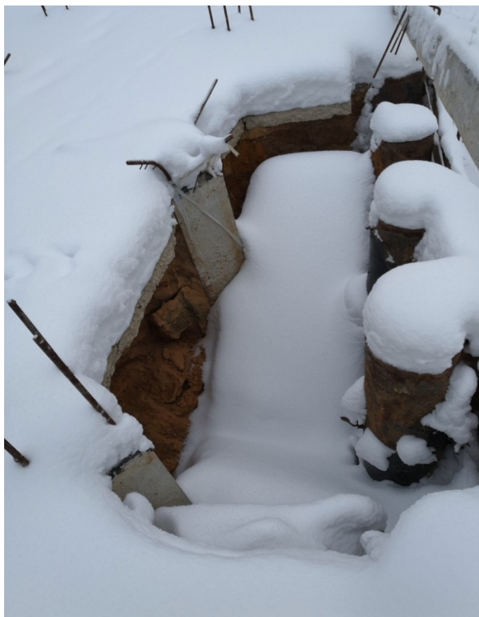
П. 5.3. Вымыв грунта вдоль шпунтового ограждения
