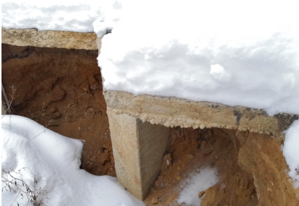
П. 5.5. Фрагменты конструкций с вымывом грунта
