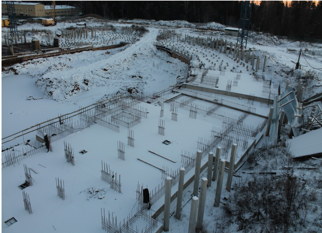
П. 5.7. Неполностью погруженные сваи по контуру котлована дома 14
