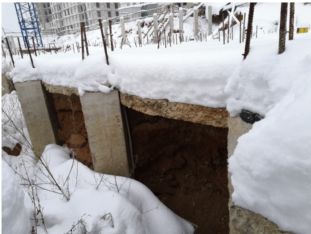
П. 5.6. Фрагменты конструкций с вымывом грунта
